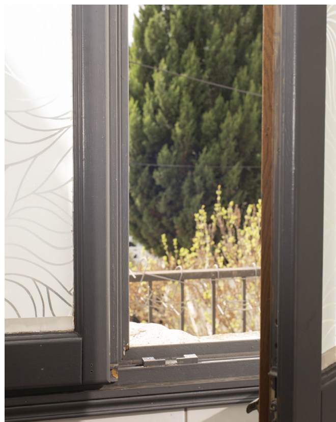
La réparation du verrou défectueux, préalable à tout nouveau départ.
